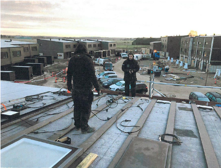
Figur 1.5.21. Her kan ses hvordan Micro invertere er indpasset imellem terrassebrædder monteret ovenpå paptaget i Filmhusene byggeriet der er svanemærket 2020 byggeri og udført af Bonava.
