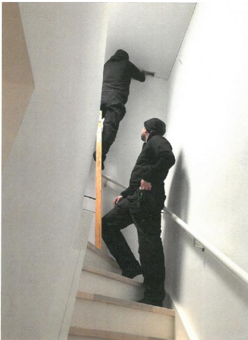
Figur 1.5.22. Gennemførelse af ledningsføring for solstrøm fra taget og ned til El-tavle under trappen.
