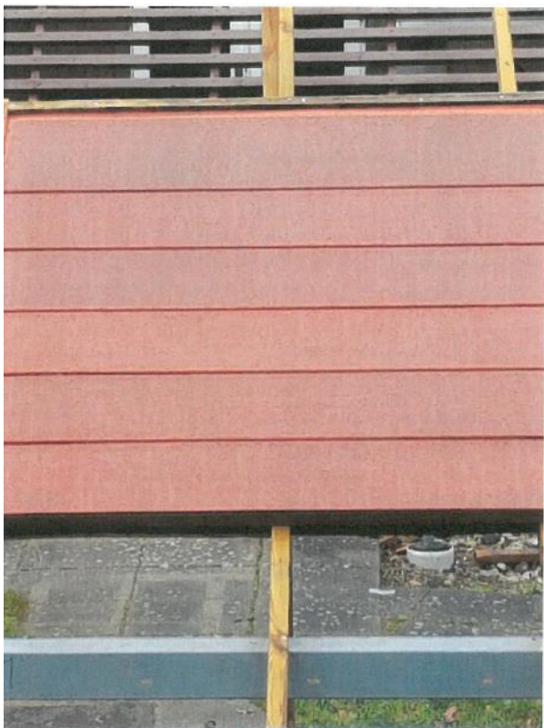
Figur. 1.5.3 Ny solcelle løsning til røde tegltage opsat på BIPV Demosite på Teknologisk Institut I Tåstrup.
