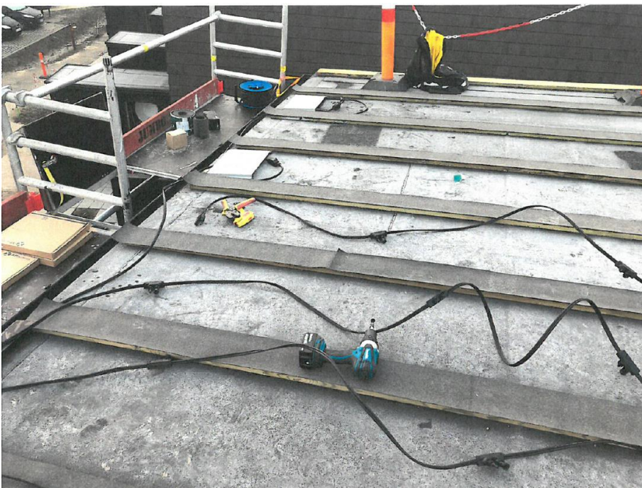
Figur 1.5.16. Ledninger og 2 Micro invertere placeret i taget imellem de monterede terrassebrædder.
