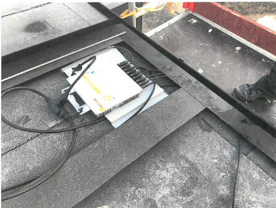
Figur 1.5.20. Hovedstation for de 3 Micro invertere der er monteret i taget.
