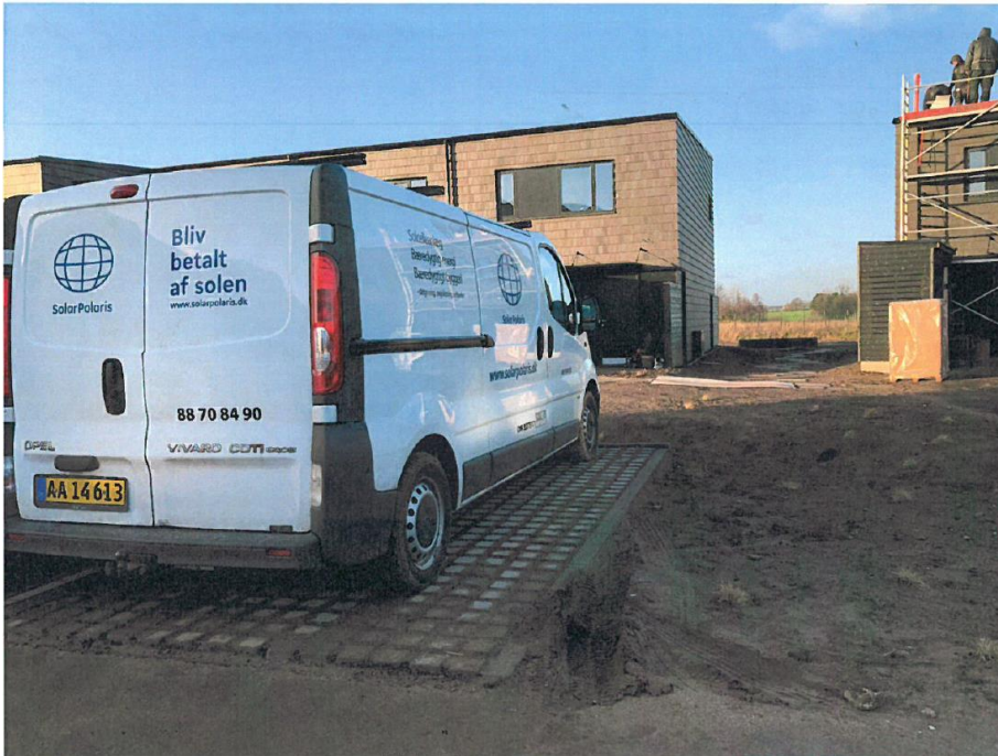
Figur 1.5.15. "Solarpolaris" udførte et fortrinligt montage arbejde i Filmhusene i Værløse
