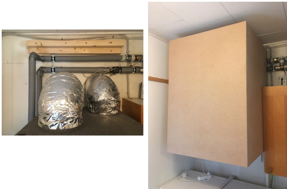
Figur 8 Foto af kondens- og støjisoleringsløsning på den eftermonterede luft/vand-varmepumpe i Allerød.
