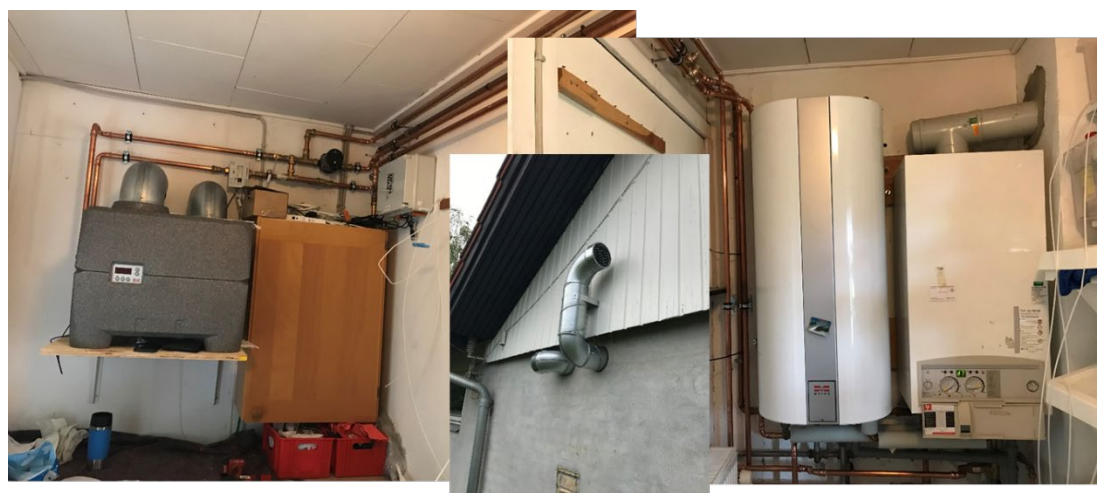
Figur 7 Foto af eftermonteret luft/vand varmepumpe (inkl. udeluftkanaler og styrboks) på gaskedelinstallation i Allerød.
