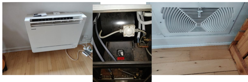
Figur 10 Foto af gaskedelbaseret kaloriferfyrede varmeanlæg i Silkeborg med luft/luft-varmepumpe (inkl. AirPatrol styreenhed).
