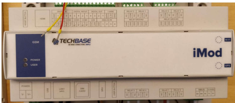
Billeder: Udstyr anvendt til måling af el- og varmekonsum samt dataopsamling
