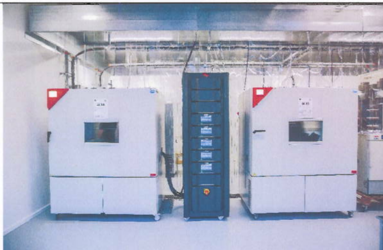
Figur 4 Digatron MCT-RE batteri celle test system efter installation med tilhørende klimakammer.
