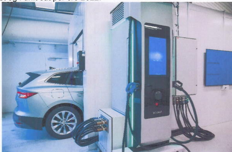
Figur 2 Siemens SiCharge-D 300 kW lader efter installation. Tilhørende klimakammer ses i baggrunden.
