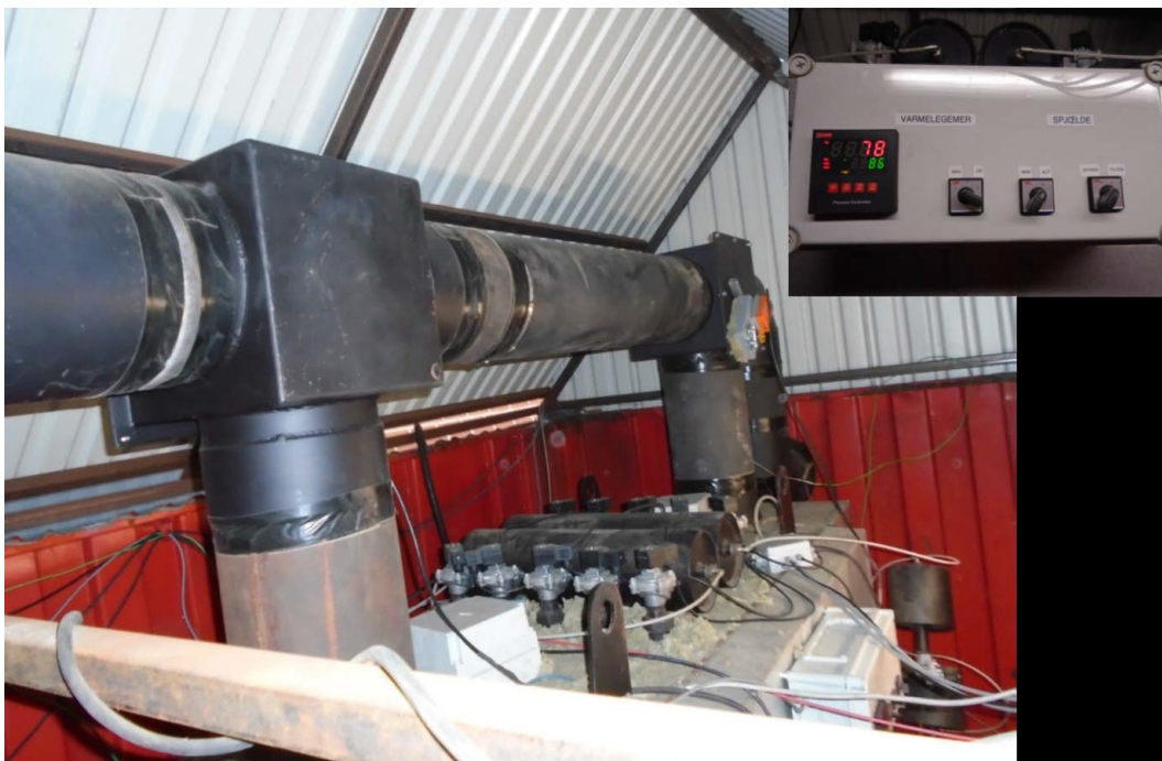
Figur 4. By-pass rør og spjæld monteret ovenover filteret. På filteret er monteret en styreboks for varmelegemerne på isolatorer samt bypass spjældene.
