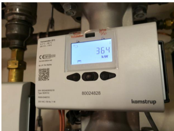
Energimåler på fjernvarmeproduktionssiden
