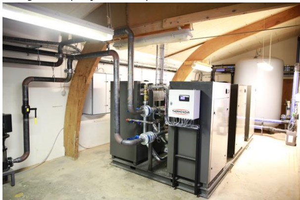
Varmepumpeinstallation hos Unika
