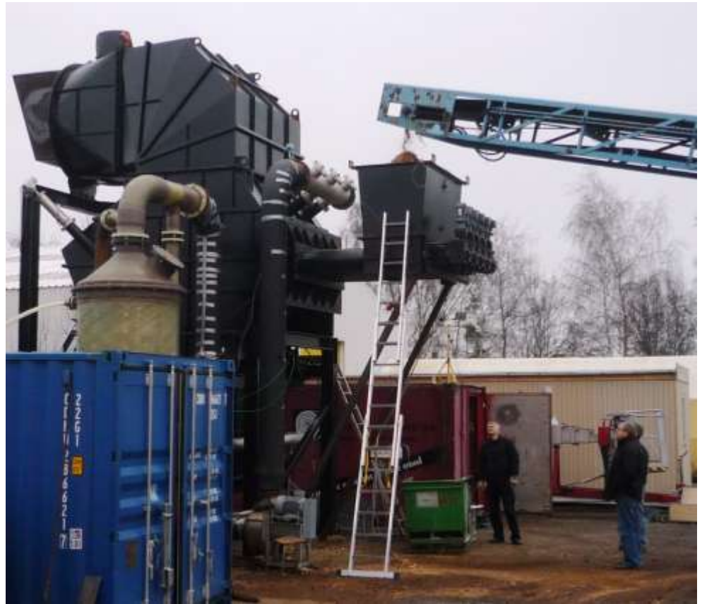
Figur 4.1 Finn Pedersen, Chimney Lab (Tv) og Bjørn Teislev, Dall Energy (Th) besigtiger anlægget under partikel måling.
