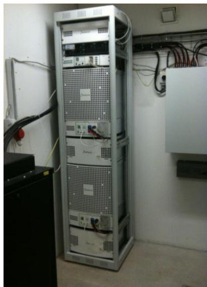
Billede 27: Komplet 10kW installation med distributionstavle
