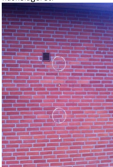
Billede 21: Opmærkning til procesluft afkast
