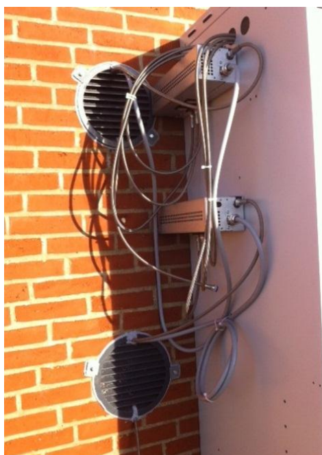
Billede 22: Ventilblokke monteret på flaskeskab
