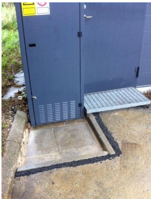
Billede 15: Kant-finish foran installeret flaskeskab på 5kW site
