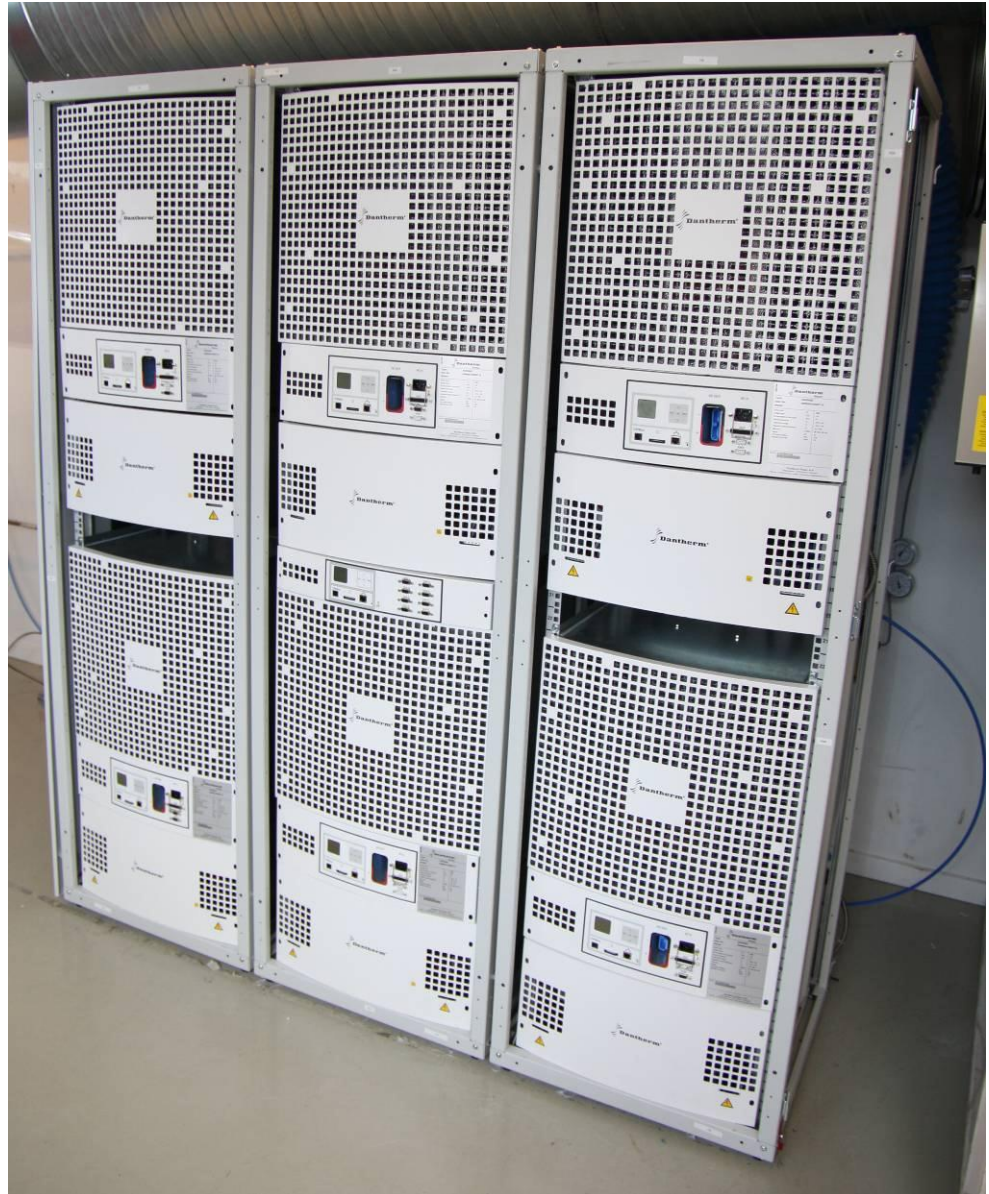
Billede 9: 30 kW anlæg installeret hos tysk kunde
