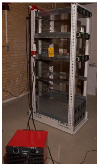
Billede 10: IT power systemet i test opstillingen. Anlægget er bestykket med et styremodul (øvets) samt to power moduler (inverter hhv. ensretter) og kan i denne konfiguration fungere som en 10 kW dobbelt konversion UPS.
