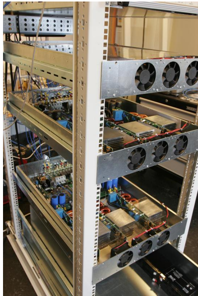
Billede 2: System rack'et med enkelte konverter moduler isat.
