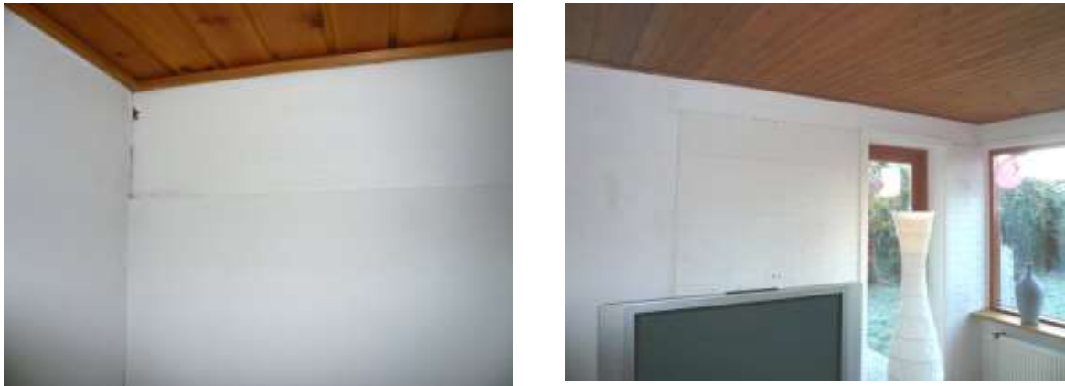
Figur 3.1. Dårligt udførte overgange mellem den oprindelige ydervægge i stuen og tilbygningen.
