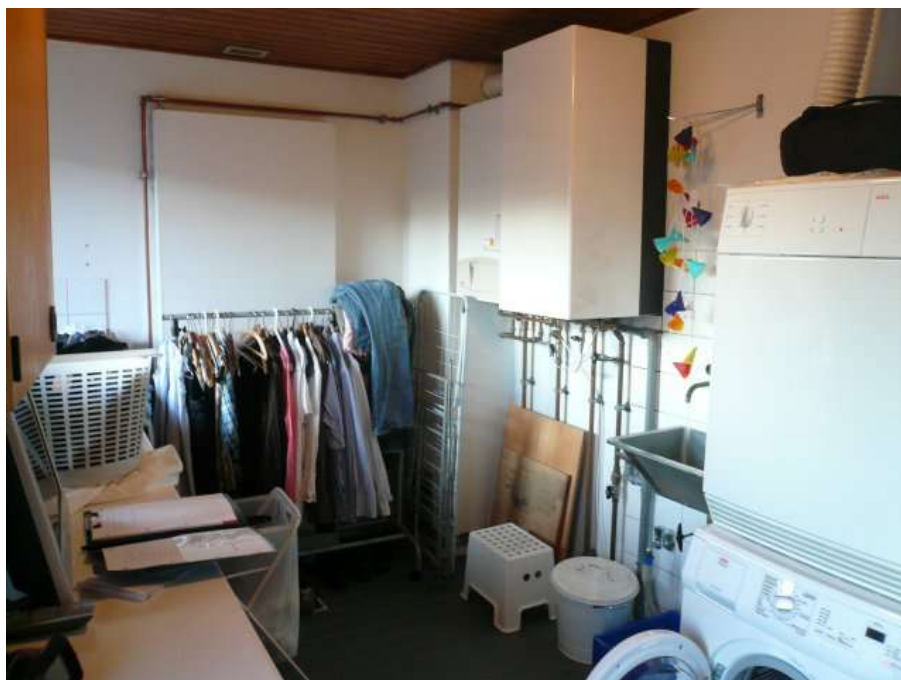
Figur 2.4. Bryggers med gasfyr og varmtvandsbeholder.
