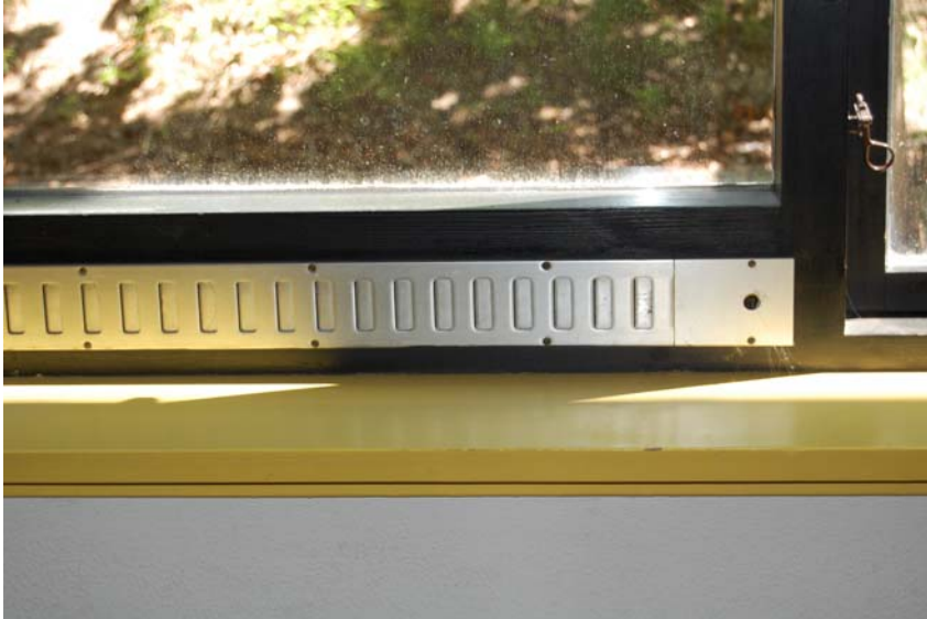
Figur 9. Friskluftspjæld i bundkarm på fast vinduesparti i klasselokale - giver træk om vinteren er derfor typisk lukket til, hvilket også gælder de oplukkelige vinduesfelter. Dette bidrager til et dårligt indeklima, herunder høje \text{CO}_2 -koncentrationer (se afsnit 2.4). Disse spjæld er ikke indregnet i vinduernes U-værdi.
