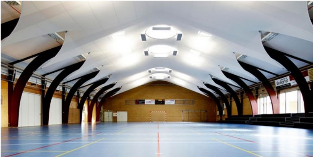
Figur 18: Billede af hovedhallen. Friskluftindtag og varmeblæsere kan anes på væggen til højre i den fjerneste ende
