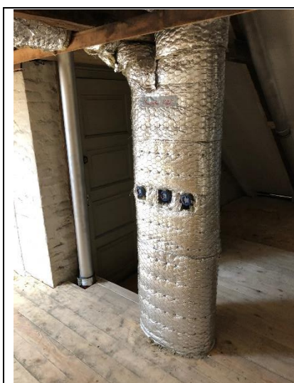
Aftræk anvendt til decentral som videreføres via trykholderventilator til eksisterende skorsten som fælles afkast
