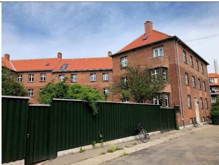
Skorstene anvendt som afkast med nye afdækninger
