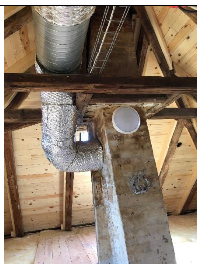
Skorsten anvendt som afkast for decentral løsning
