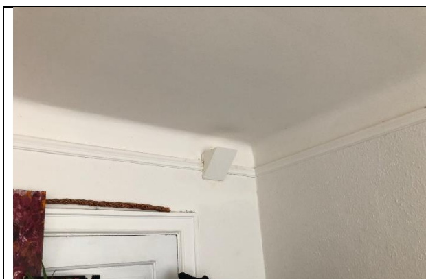
Central løsning med indblæsning via skorsten
