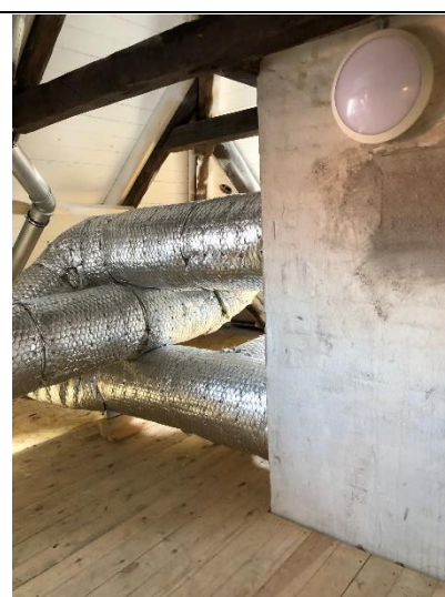
Skorsten anvendt som indblæsning under og afkast over vandret indmuret dæk
