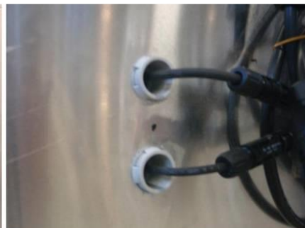
Ledningsføring til mikroinverter
