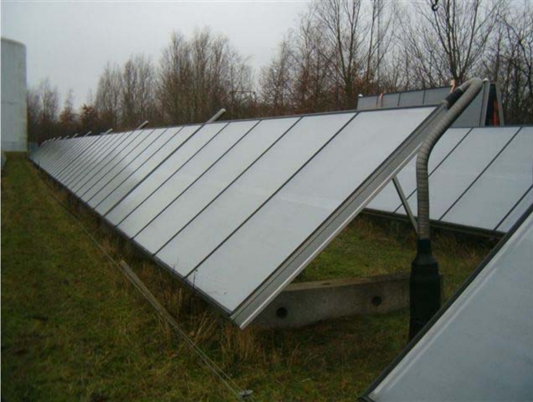
Figur 2. Solfanger i Marstal solvarmecentral før udskiftning.
