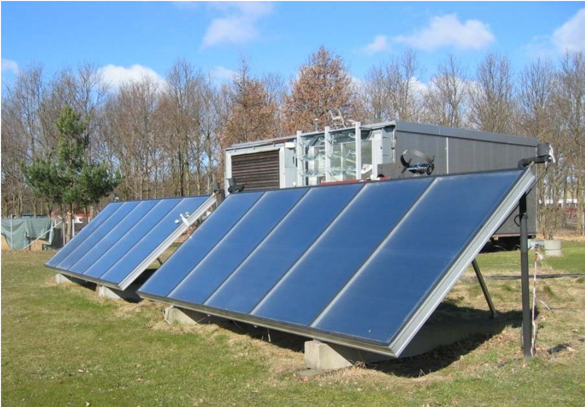
Figur 4. Solfangerne i DTU Bygs prøvestand for solfangere. Til højre solfangeren fra Marstal, til venstre solfangeren fra Ottrupgård.
