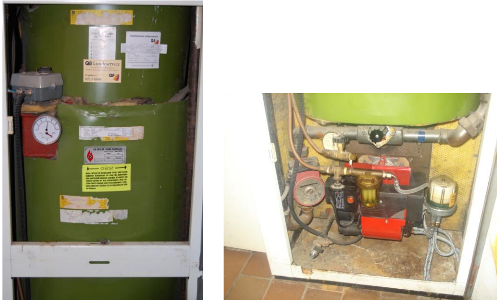
Figur 9. Kælder med oliefyr og integreret varmtvandsbeholder. Billedet til højre viser bunden af unitten med ældre Grundfos pumpe (UPS) og brænder mv.
