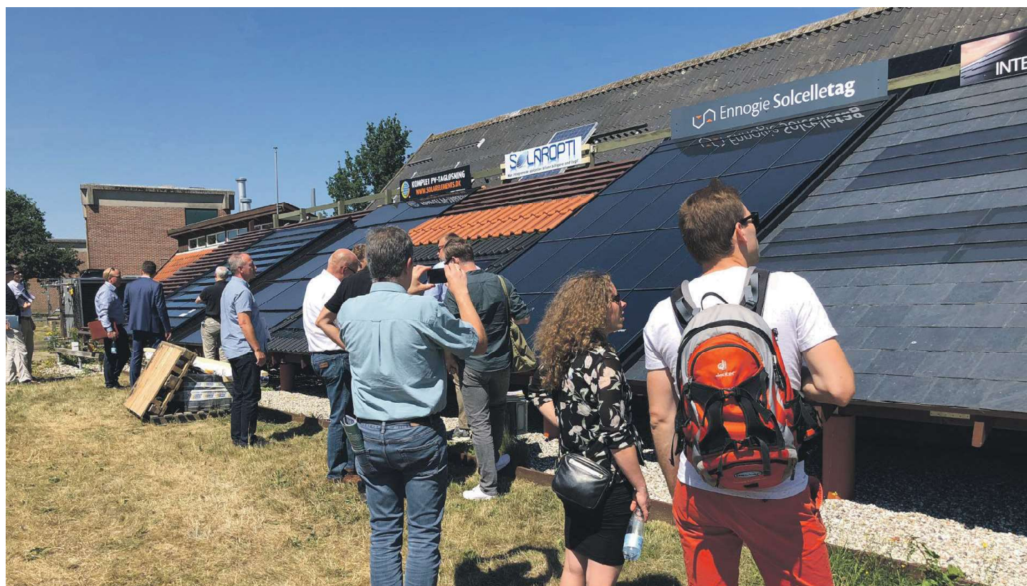
Såkaldt BIPV Demosite for bygningsindpassede solceller, der er etableret på Teknologisk Institut i Tåstrup koordineret af firmaet Solarplan.
